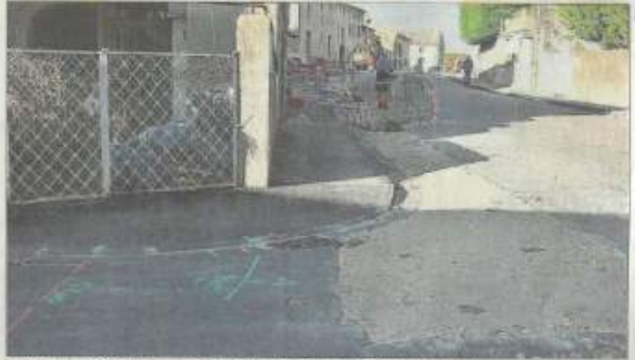
Pour la majorité un pluvial est présent, des grilles sont installées dans la rue.
