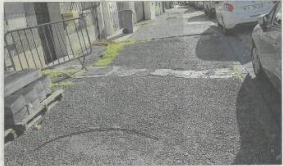
Les trottoirs sont très dégradés et impraticables sur certaines portions. Photo Le DL/Laurence DENY
