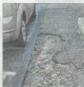
Des trottoirs peu praticables sur l'avenue des Alliés.
